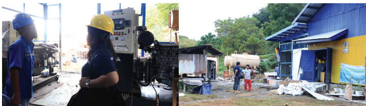
Gambar 2.33a & 2.33b Pembangkit Listrik Tenaga Diesel di Pulau Moyo
